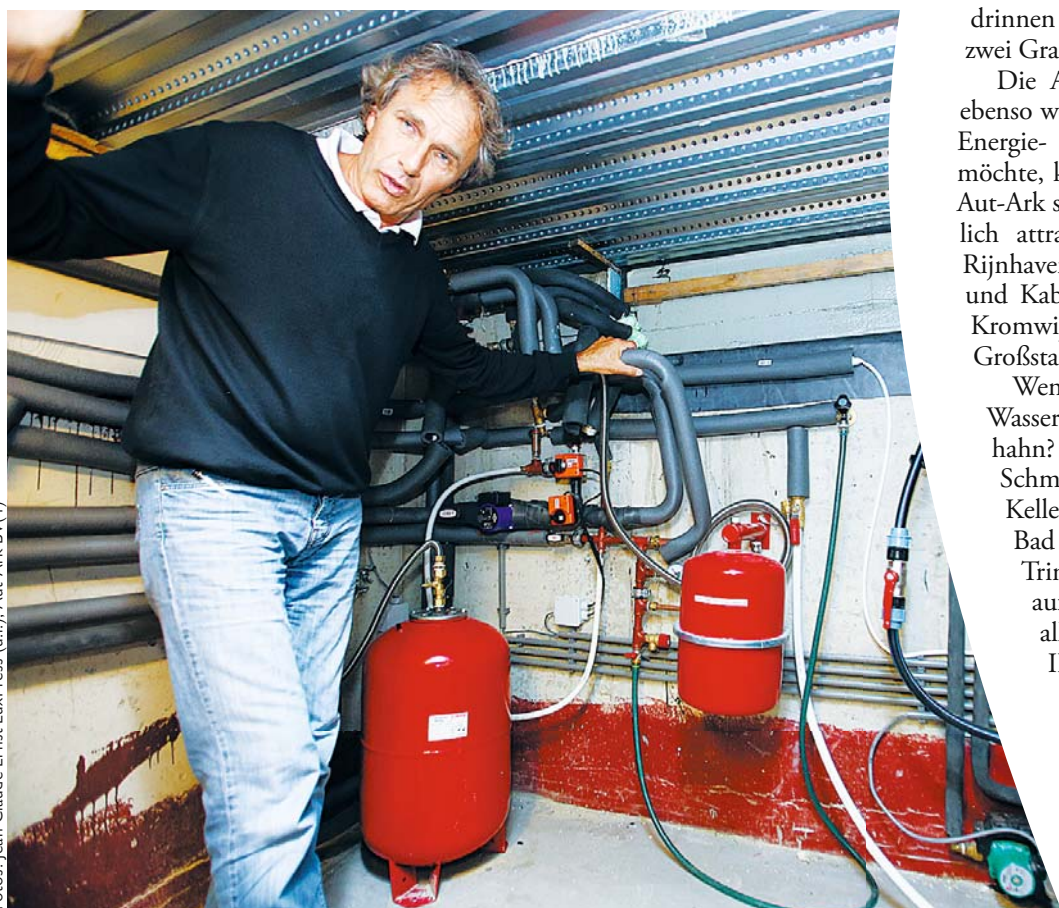
Moderner Noah: Der Architekt Pieter Kromwijk im Heizkeller
